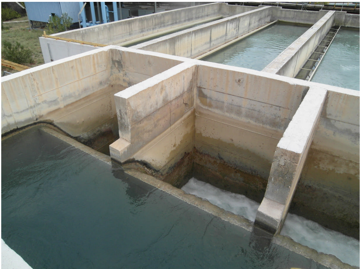
ripartizione acqua alla filtrazione
